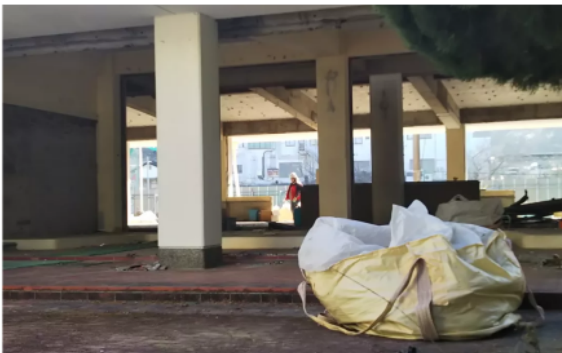
高学年棟 玄関外部 扉が撤去されてます。
