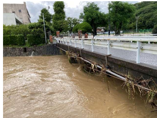
↑ 橋げた付近まで濁流の痕跡 (天神橋)
