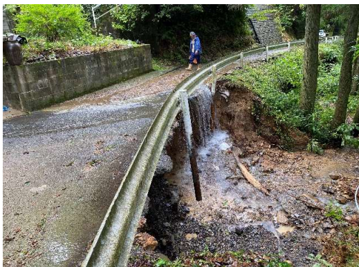
↑ 道路の下が大きくえぐられた市道
