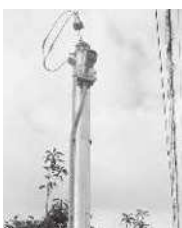
▲防犯カメラ設置状況
